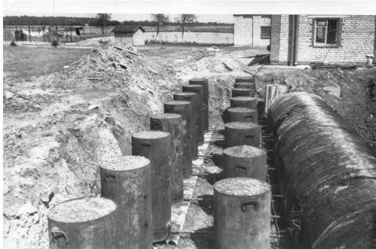
Рис. 6. Завершена установка водобалансовых лизиметров с монолитами почвы на постоянное место лизиметрической площадки (слева) и монтаж подземной части (галереи) лизиметрической станции
