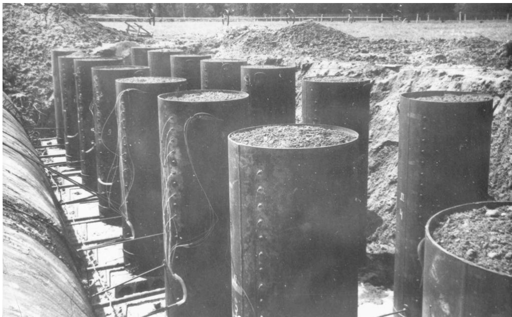
Рис. 8. Установка датчиков на водобалансовых лизиметрах и вывод их в подземную галерею (тоннельное помещение) лизиметрической станции
